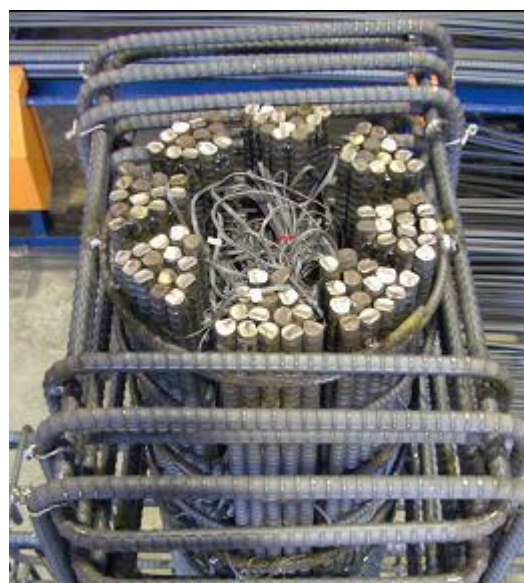
配筋状況例(鉄筋比 23.1%)
